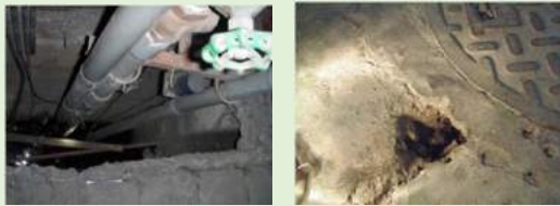
地下室污水池及孔洞破裂
