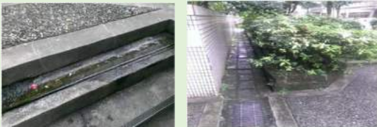
社區排水溝淤積及積水
