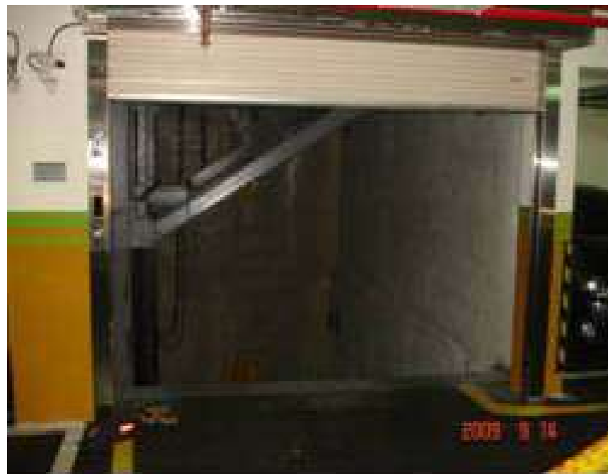
地下2樓（B2）停車設備外觀
