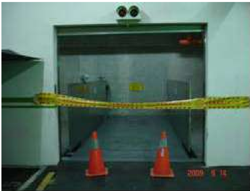
地下1樓（B1）停車設備外觀
